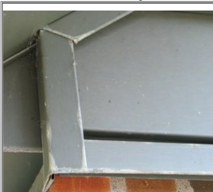
4. De hvide områder langs klippekanter og på ombukkede kanter skyldes korrosion og dannelse af zinkkorrosionsprodukter under lakken.
