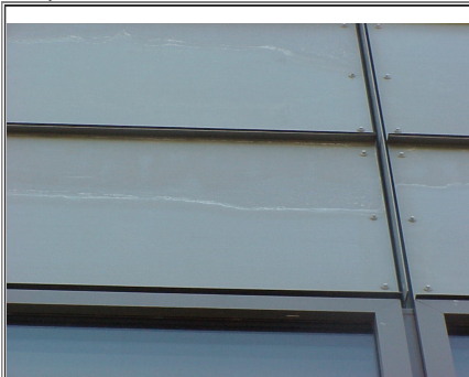
3. Facadeplader med en hvid linje af zinkkorrosionsprodukter dannet på grund af fugt mellem tæt stakkede plader under oplagring.
